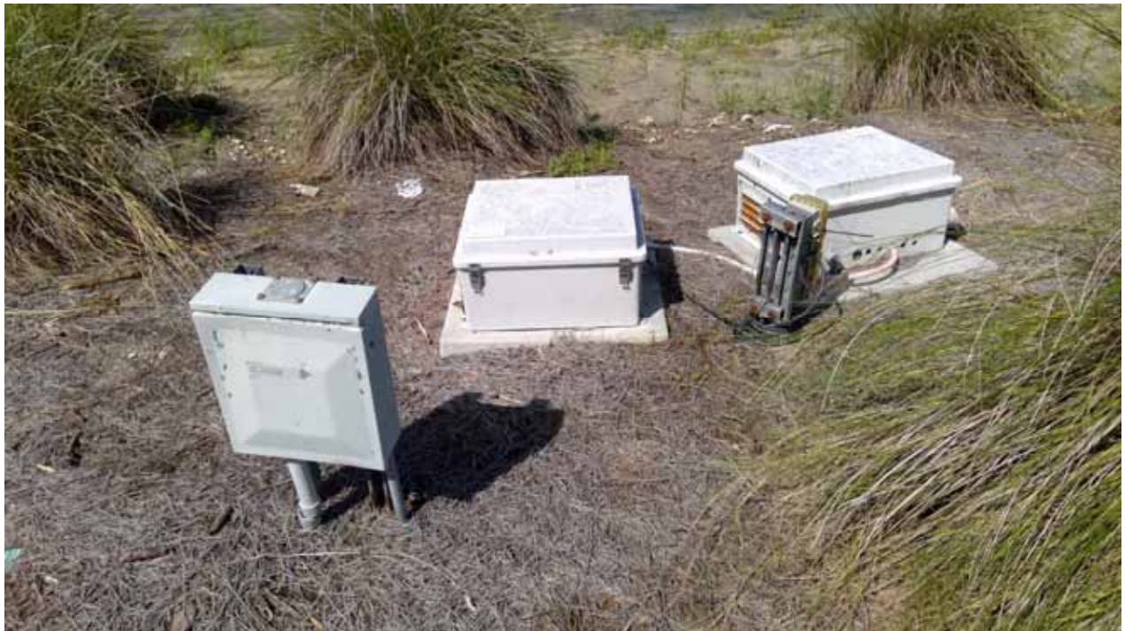
Lake Aerator 6D & 6E
