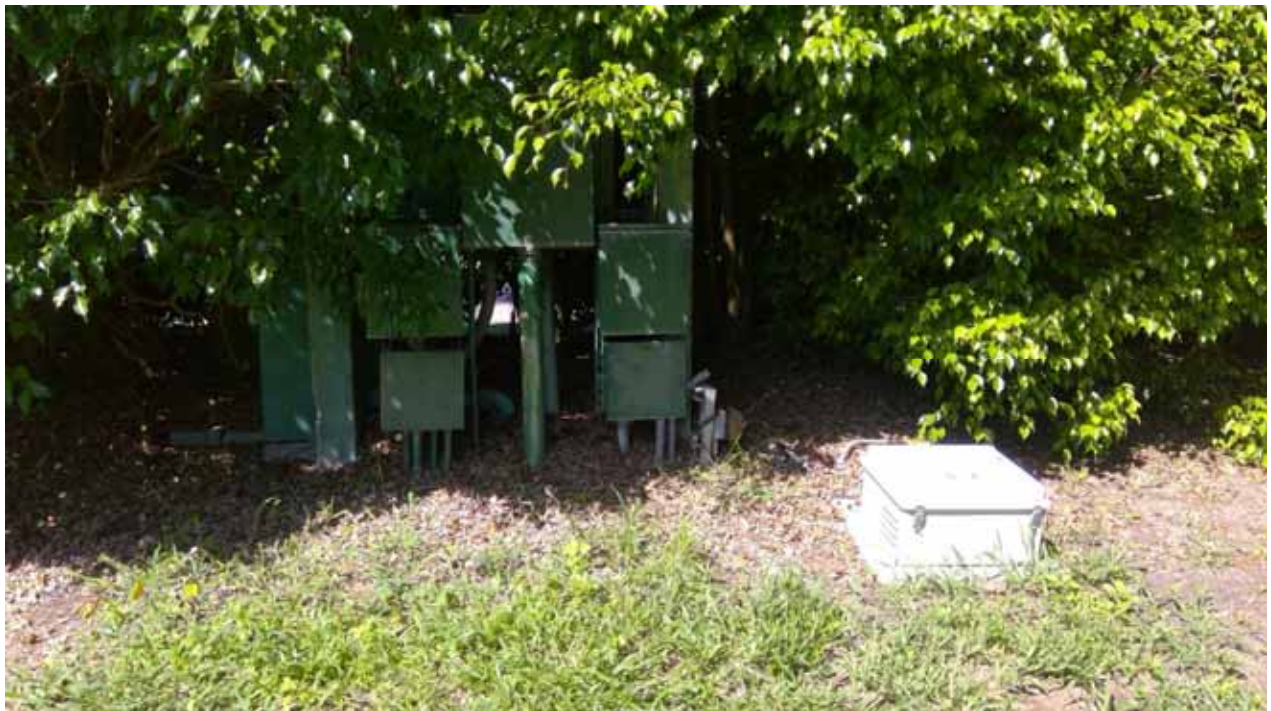
Lake Aerator 6B & 6C
