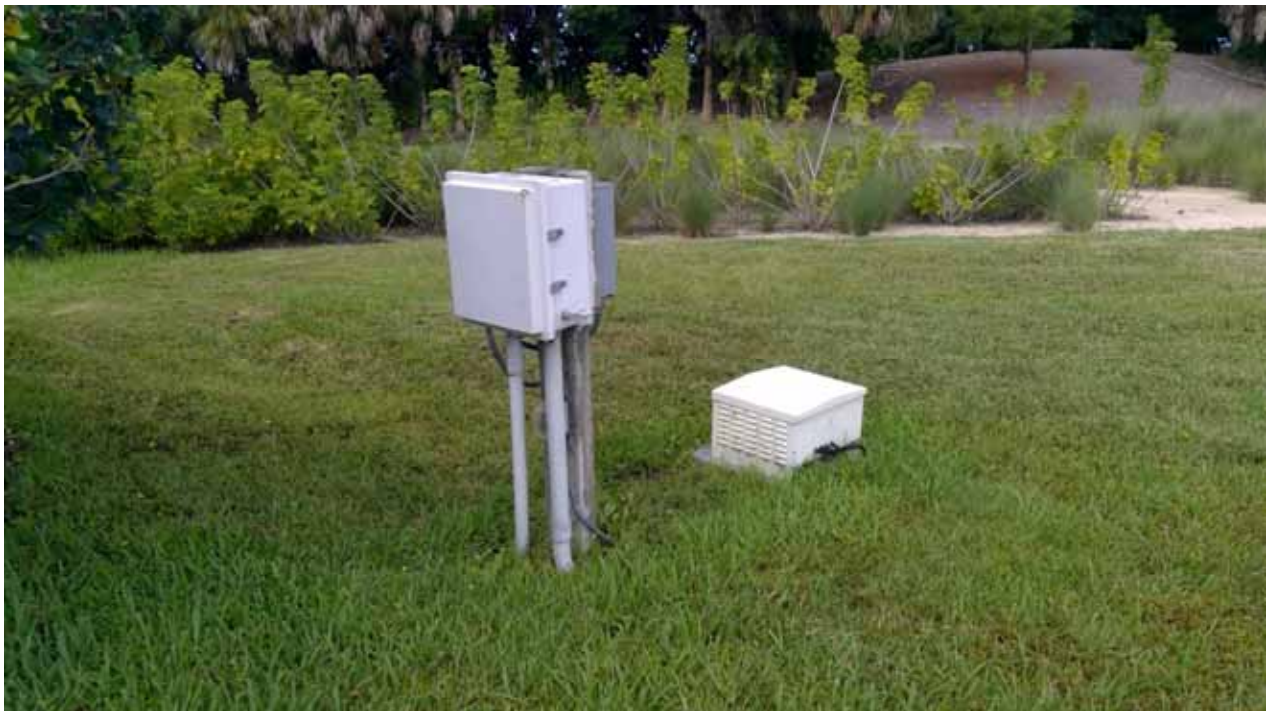
Lake Aerator 3A
