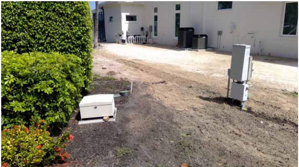
Lake Aerator 1A
