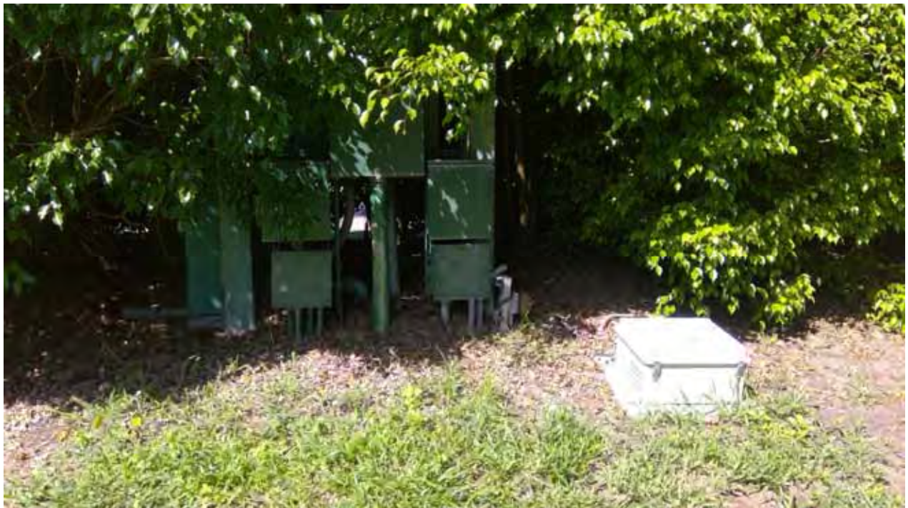
Lake Aerator 6B & 6C
