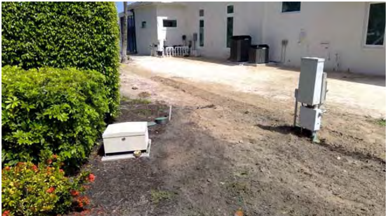
Lake Aerator 1A
