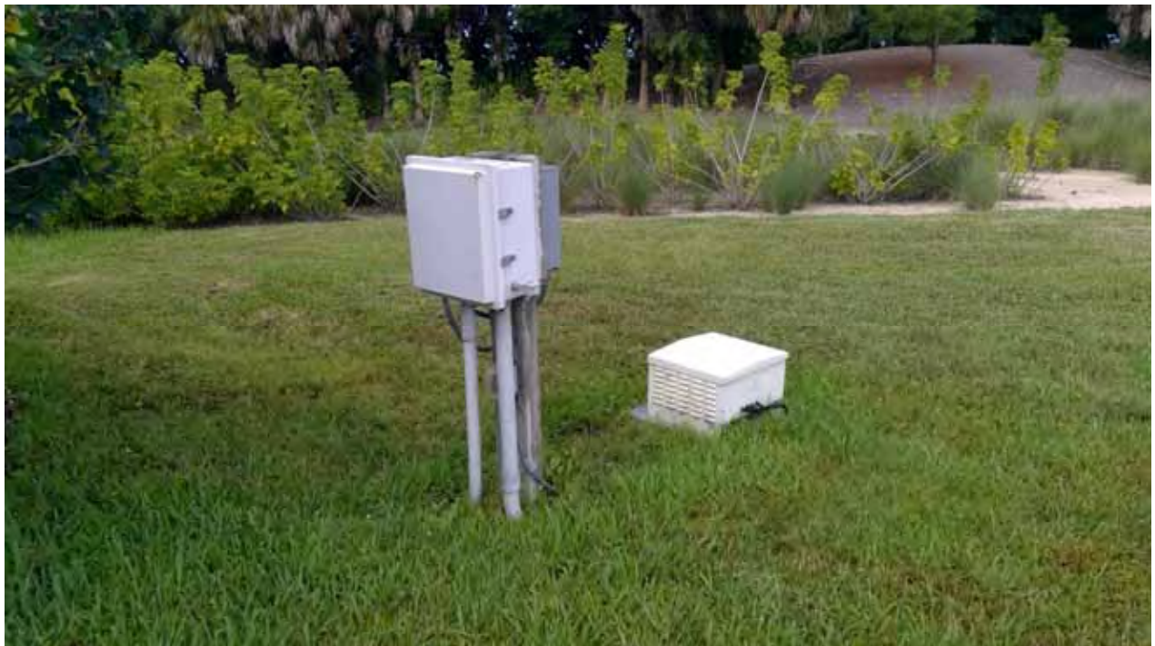
Lake Aerator 3A
